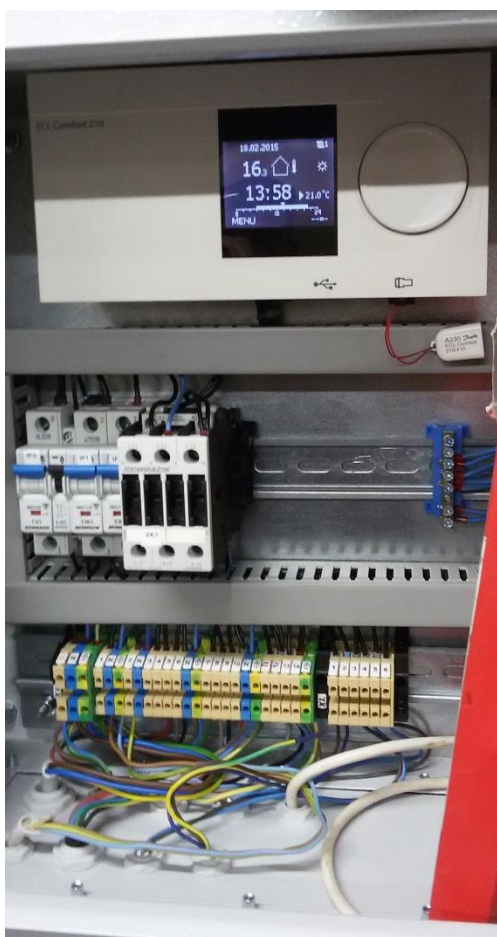
Slika 9. Kontrolno sučelje izmjenjivača topline
