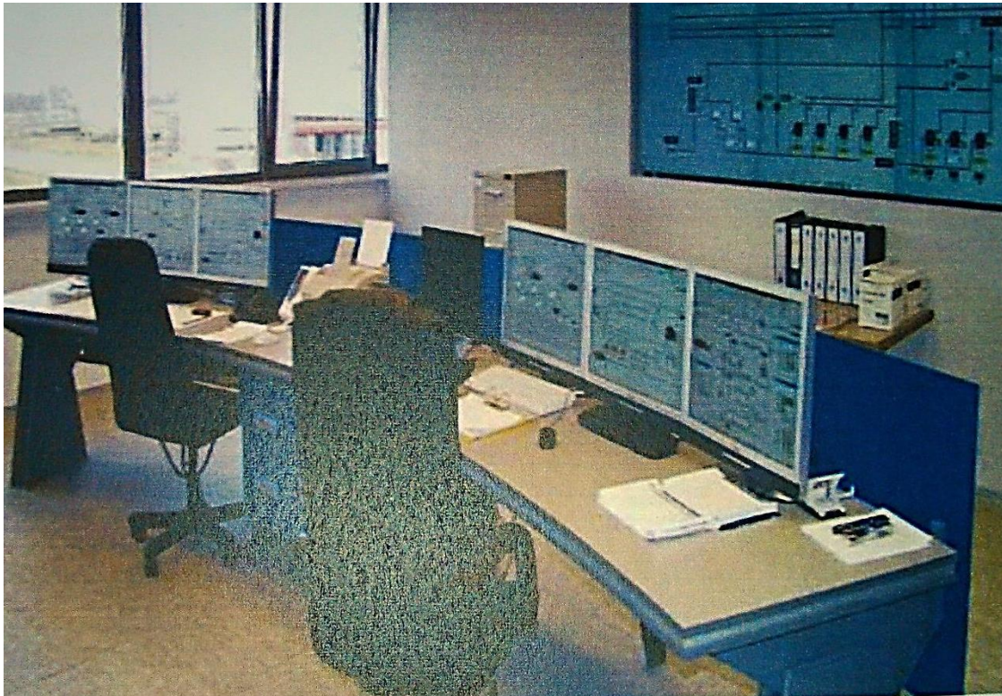
Slika 29. Kontrolni centar SCADA u Sisku
