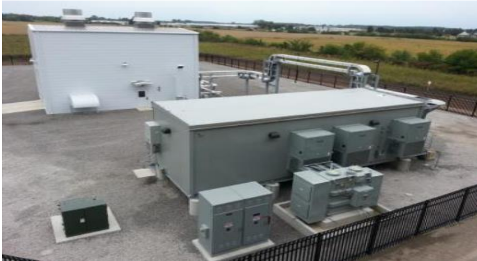
Slika 21. Pumpna stanica naftovoda
