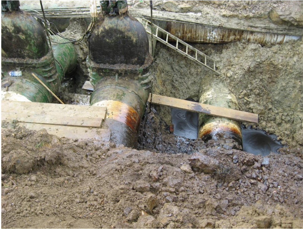
Slika 35. Sanacije cijevi koja propušta naftu, [11]
