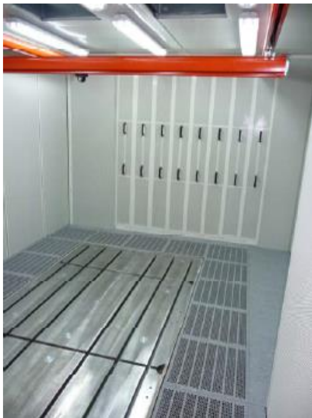
Slika 10.4. Kabina s elastično uležištenim temeljom na zračnim oprugama
