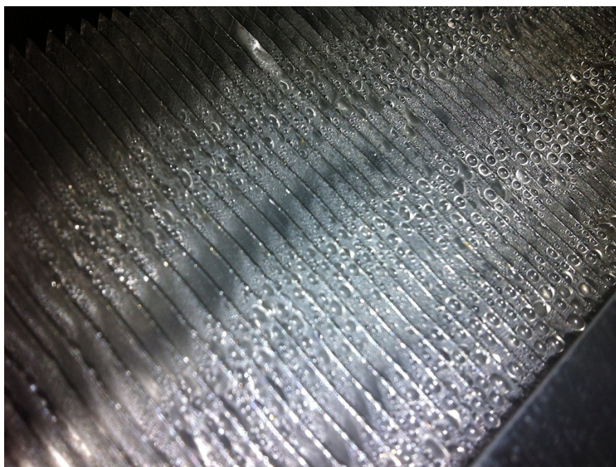
Slika 85. Prikaz kondenzata na lamelama izmjenjivača
