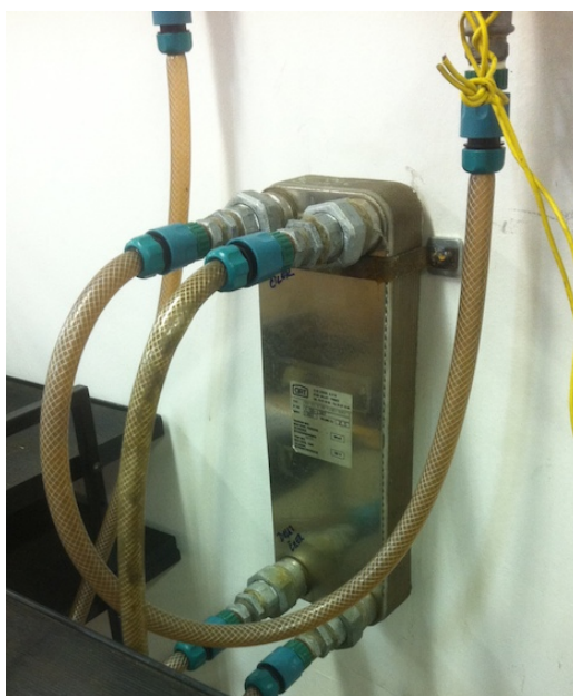
Slika 25. Pločasti izmjenjivač rashladnog kruga
