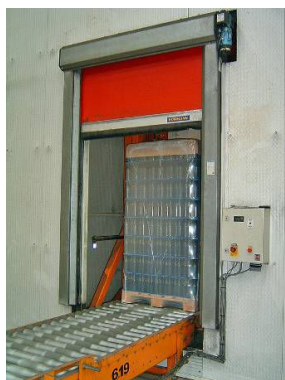
Slika 28: Izlazak palete iz lifta u skladištu
