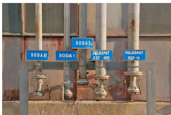
Slika 23: Ventilni sustav za pneumatski transport
