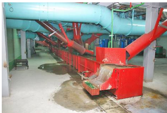
Slika 21: Bazeni za hlađenje vrućih škartnih staklenih spremnika
