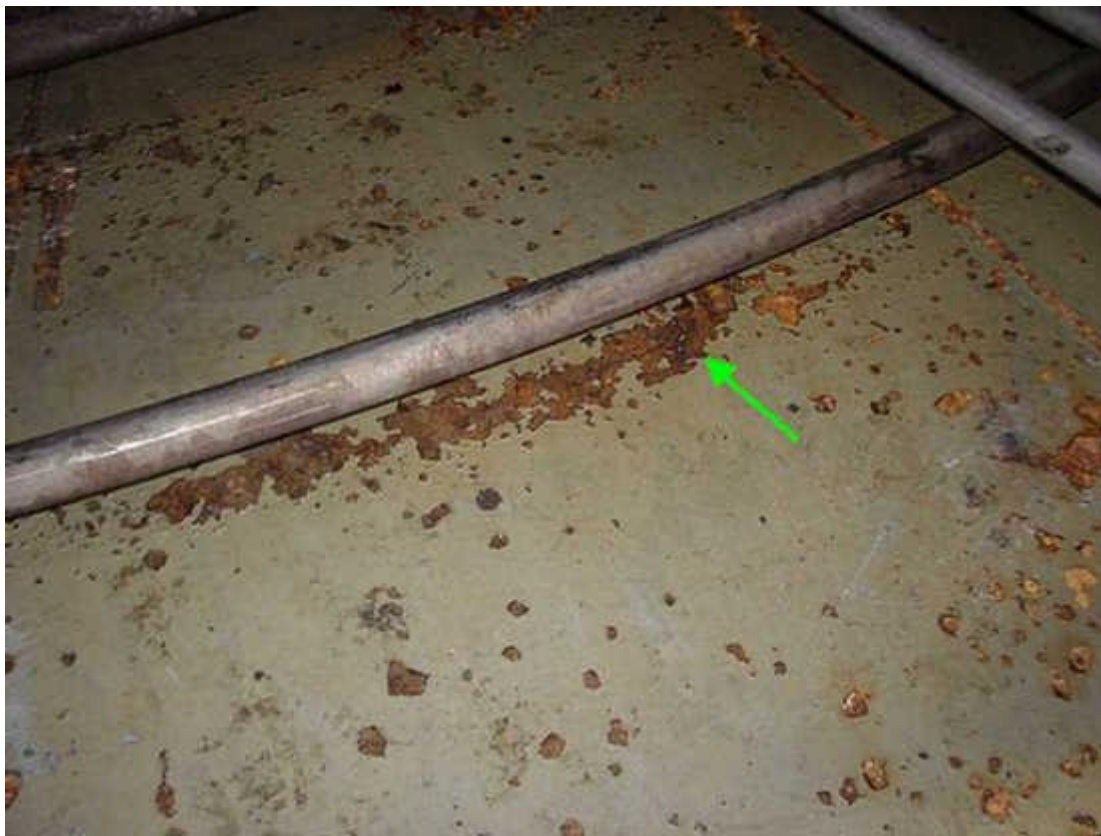
Slika 20. Primjer galvanske korozije[27].
