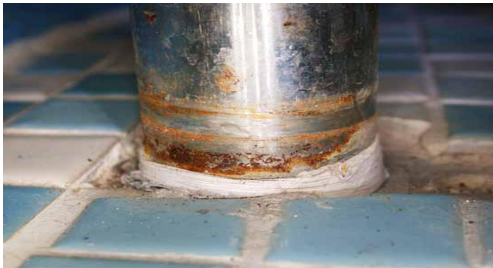
Slika 7. Korozija u kupaonici [11].
