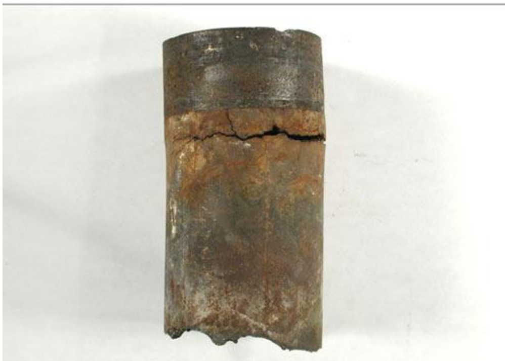
Slika 23. Napetosna korozija cijevi [30].
