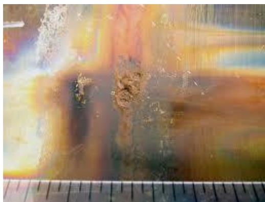
Slika 17. Rupičasta korozija na posudi bojlera [24]
