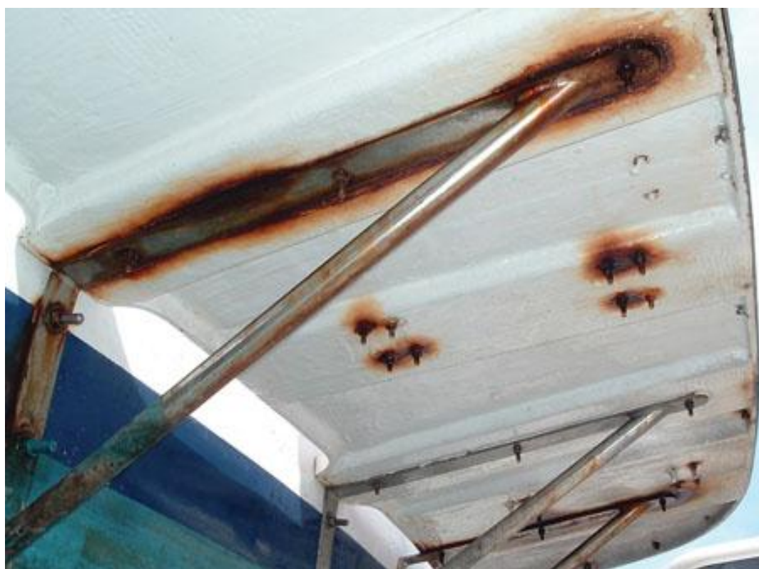
Slika 8. Korozija držača platforme od nehrđajućeg čelika na bazenu [12].
