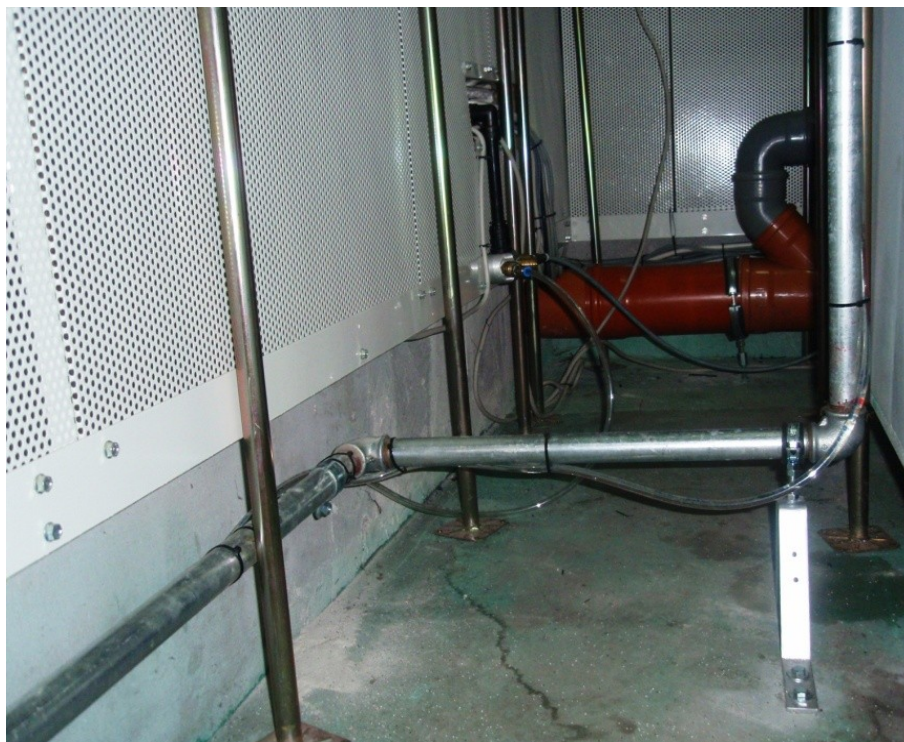
Slika 4.8. Razvod hidrauličke instalacije do ulaza u kočnicu
