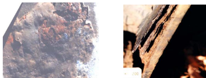
Slika 5. Bubrenje i listanje materijala kod potpovršinske korozije [4]
