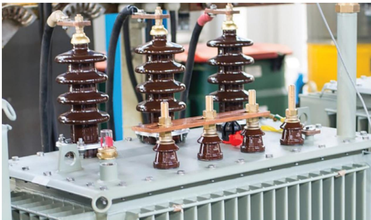
Slika 24. Priključci transformatora unutar vakuumske komore
