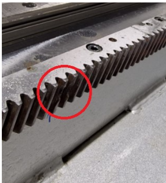
Slika 23. Oštećenje ozubljenja zubne letve
