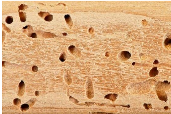
Slika 14. Oštećenja u drvu nastala djelovanjem termita [22]
