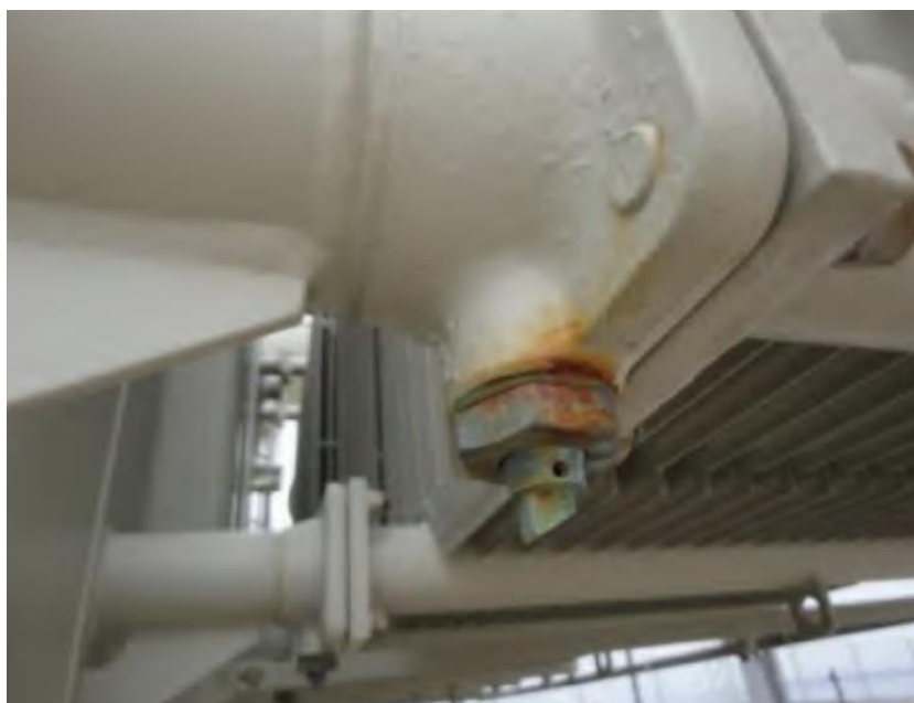
Slika 3. Korozija na čepu za ispust [6]
