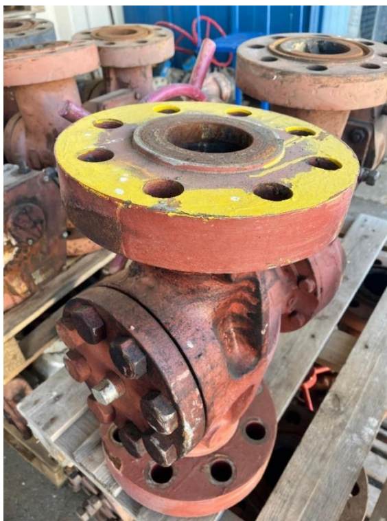
Slika 23. Ventili plinovoda pripremljeni za servis
