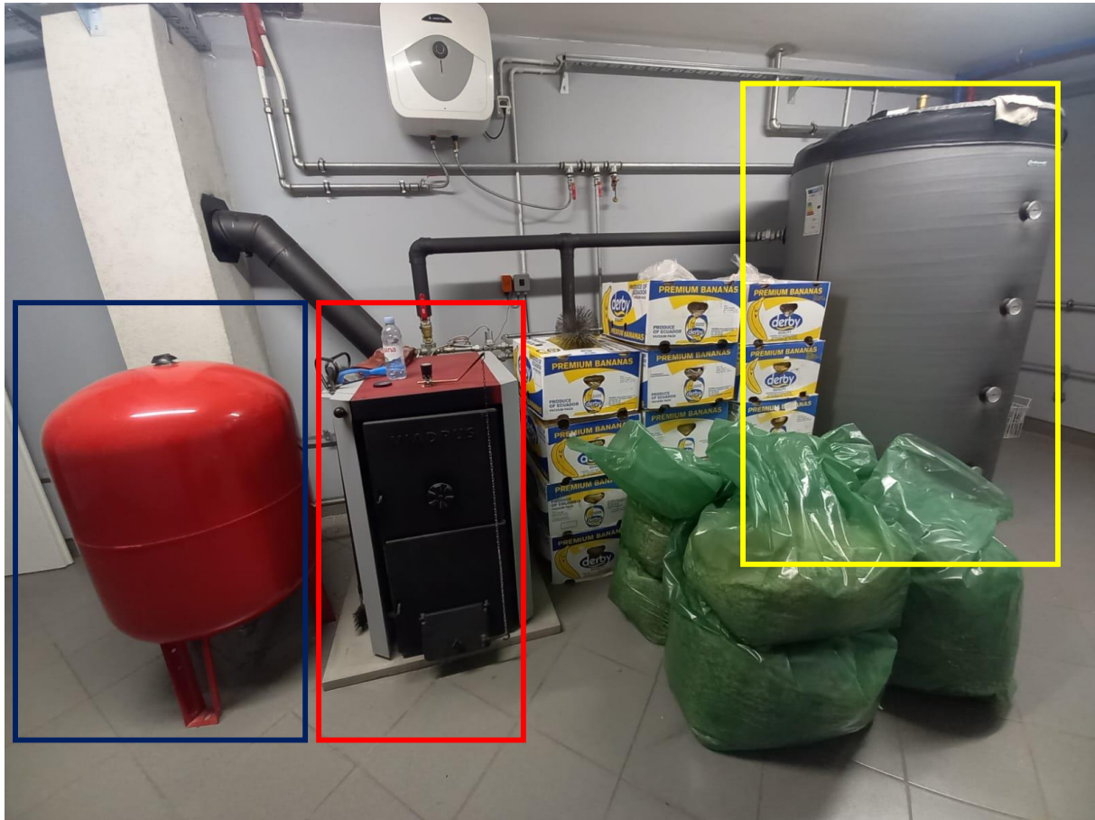
Slika 1 Postojeći sustav centralnog grijanja
