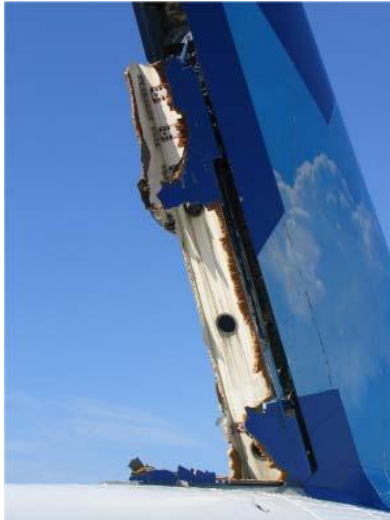
Slika 19 – Popuštanje sendvič konstrukcije uslijed kombinacije djelovanja vlage i niske temperature
