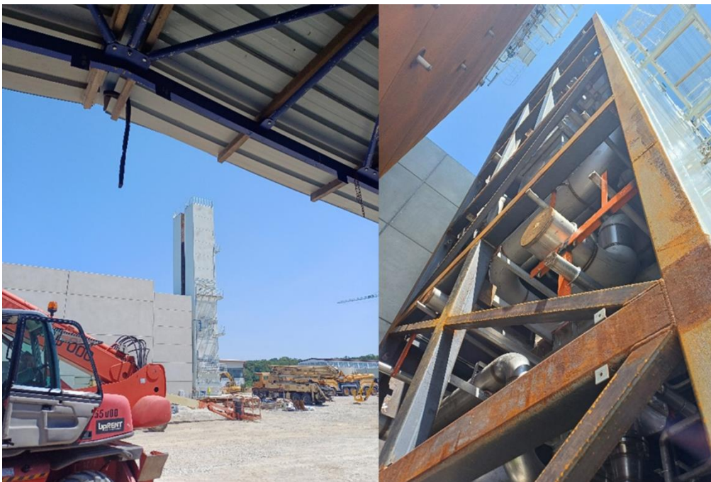
Slika 36. Industrijsko postrojenje - separator zraka
