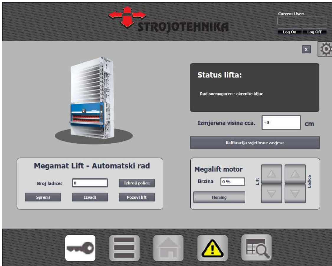
Slika 2.10: Glavni zaslon HMI-a
