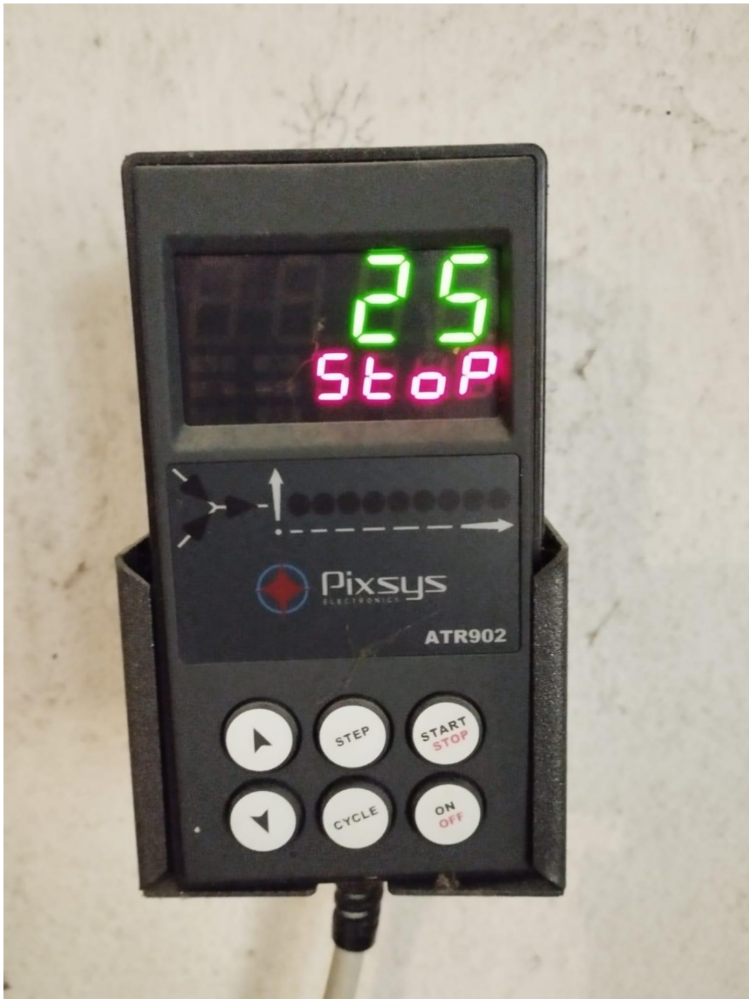
Slika 19. Programabilni kontroler ATR902 s prikazom sobne temperature na zaslonu
