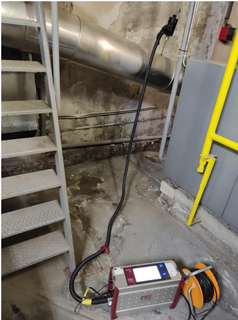
Slika 4. Mjerni instrument sa sondom umetnutom u dimovodni kanal
