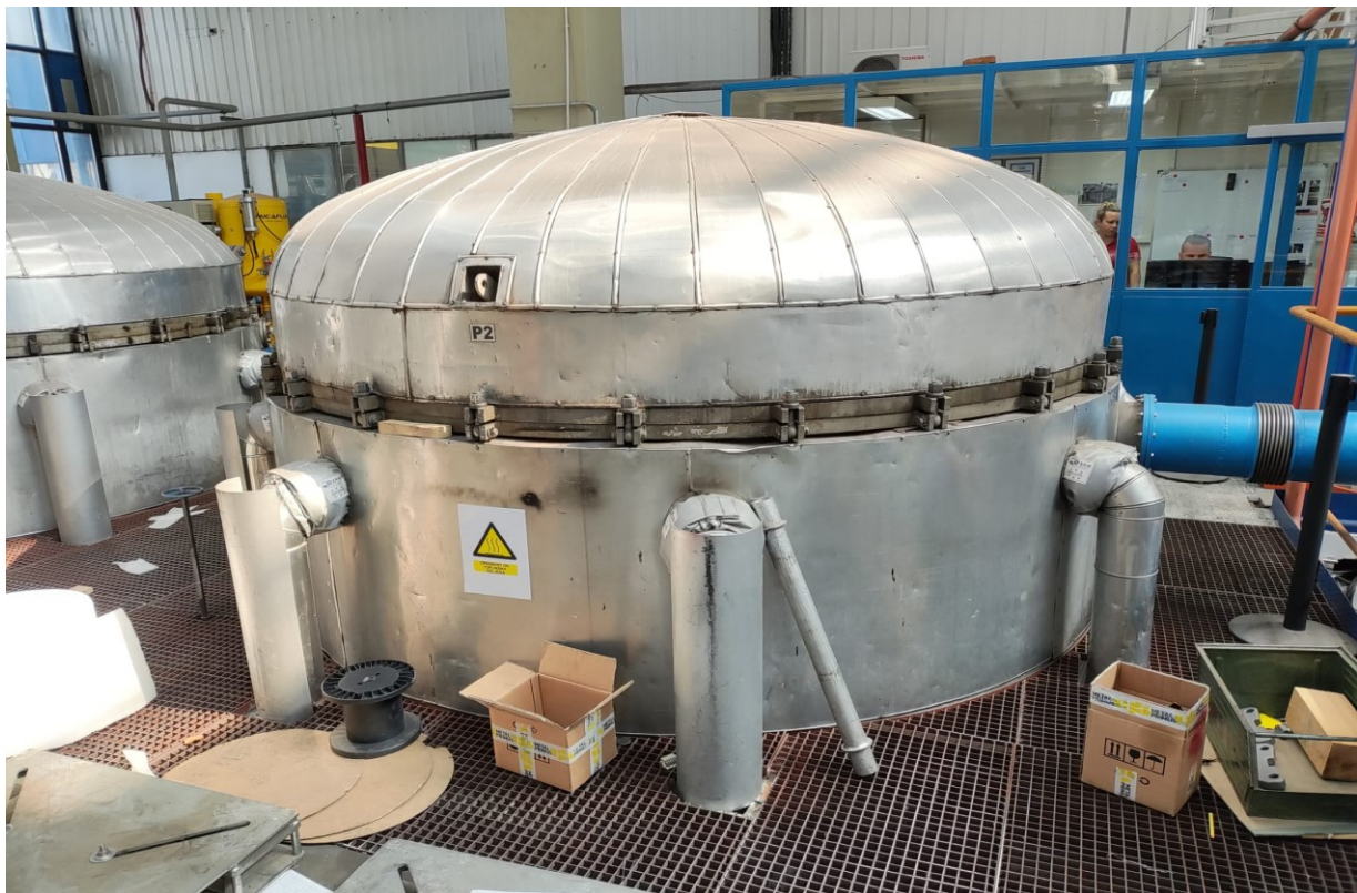
Slika 3.9 Peć za sušenje transformatora
