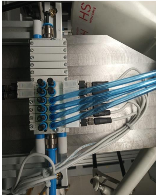
Slika 84. Prikaz instaliranog pneumatskog bloka s razvodnicima
