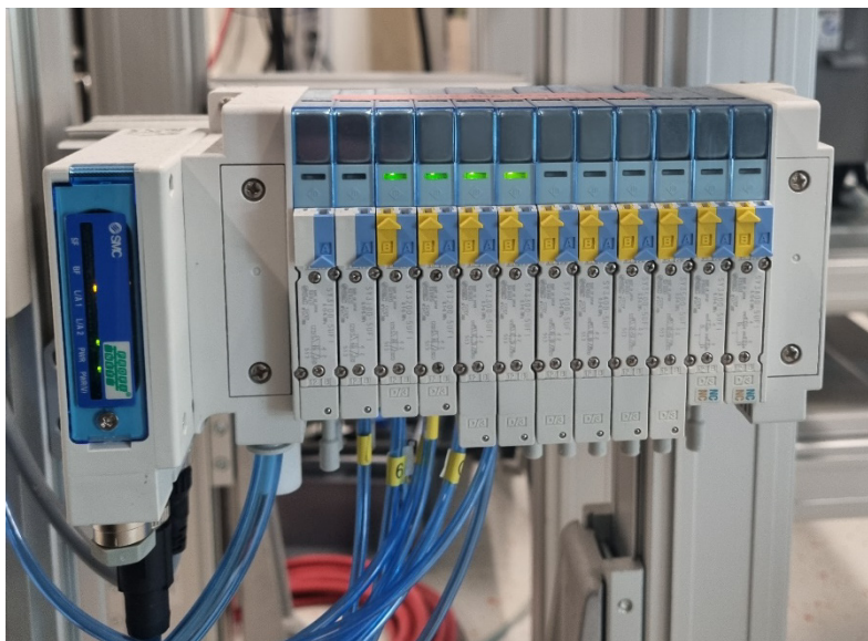
Slika 9. Elektronički ventilski blok EX260 SPN 1/2 na Montrac modulu
