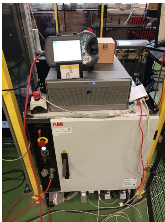
Slika 7. Upravljačka jedinica IRC5 spojena sa operatorskim panelom
