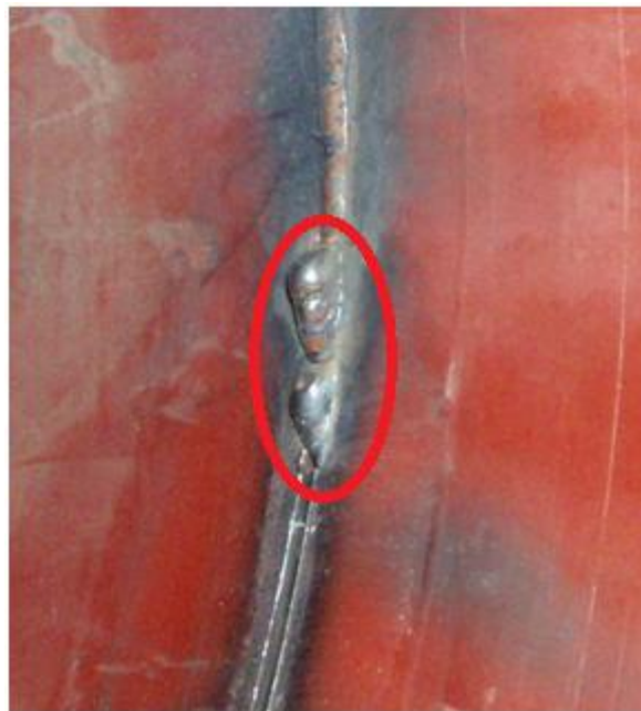
Slika 7.11 Korijen s unutarnje strane cijevi
