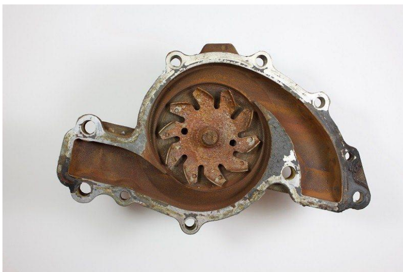
Slika 16. Korozija unutar pumpe [20]
