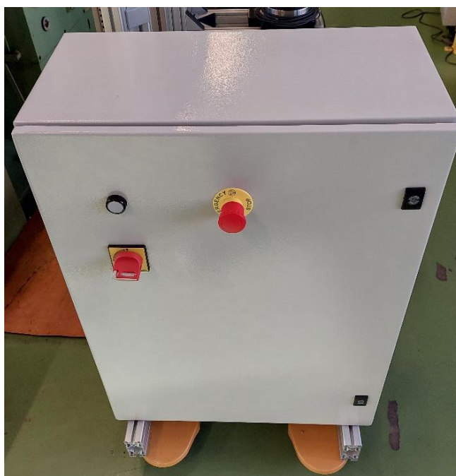
Slika 13. Sklopka i tipkala na vratima upravljačkog ormara
