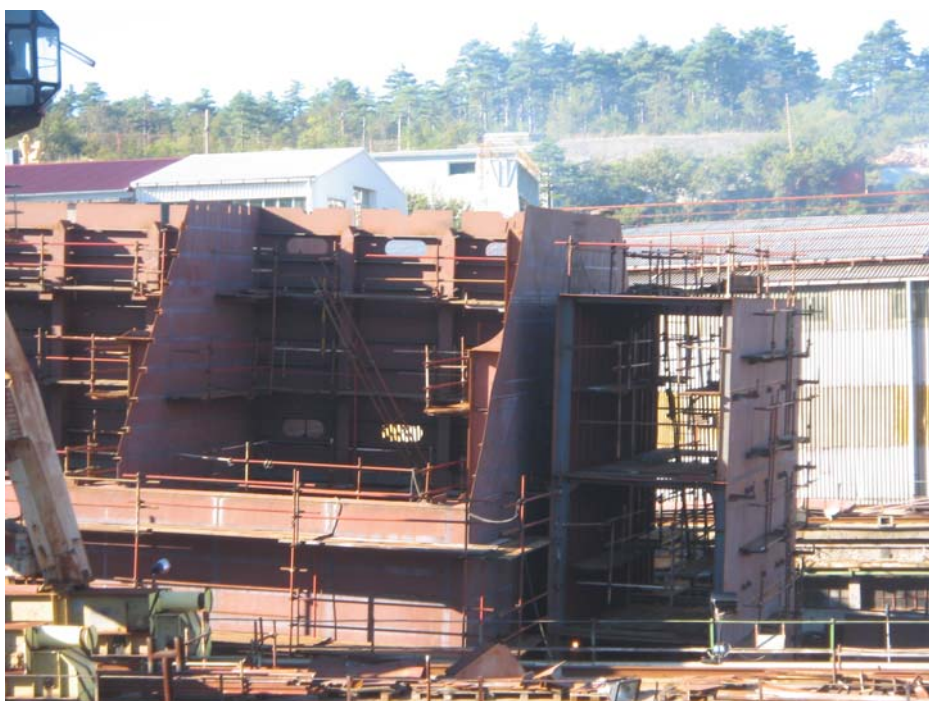
Slika 41 Montirane grupe pregrada pumpne stanice i bloka tankova tereta br. 2
