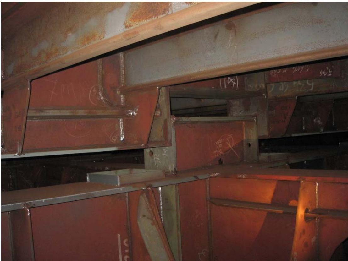
Slika 16 Ojačana struktura dna broda i dna tanka tereta u zoni protuljuljnog ključa
