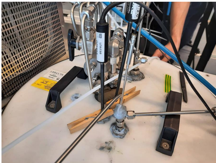
Slika 6. Poklopac primarnog generatora
