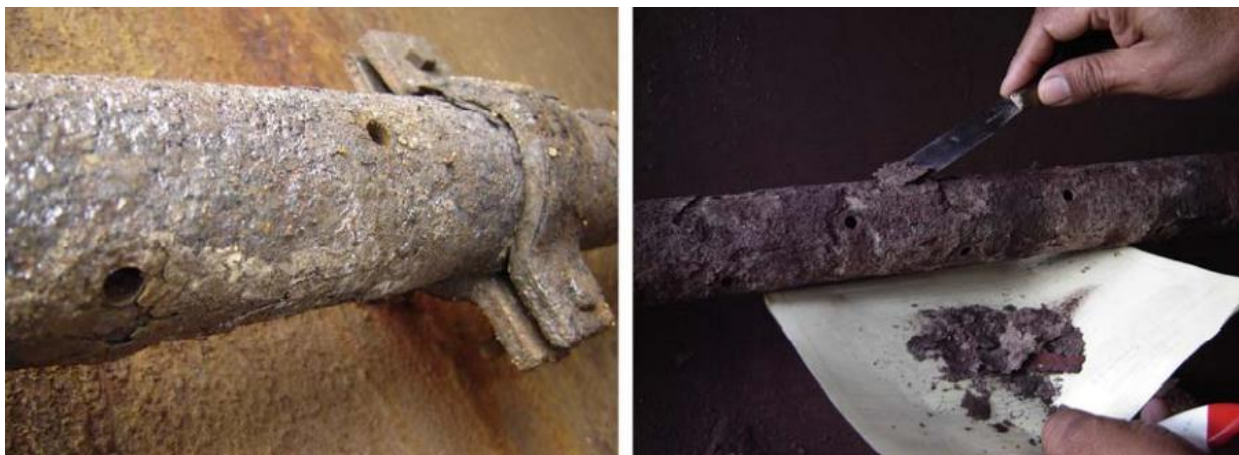
Slika 18. Korozija parne cijevi
