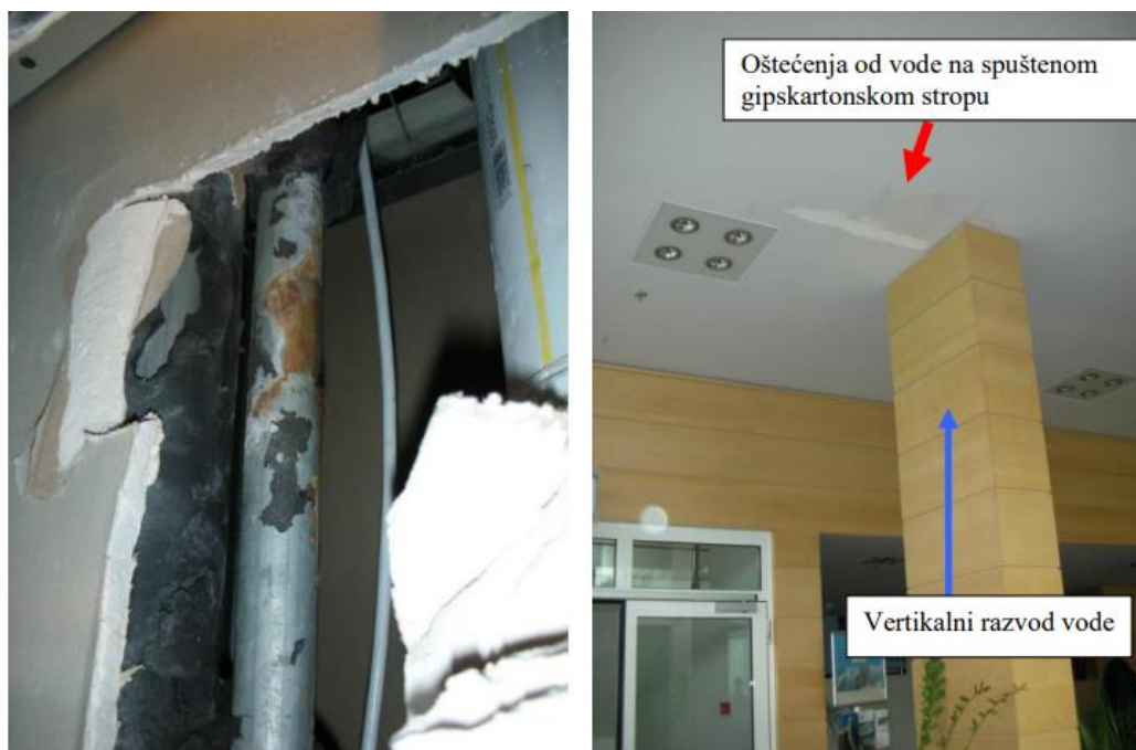
Slika 9. Prikaz oštećenja – propuštanje vode i oštećivanje objekta [10]
