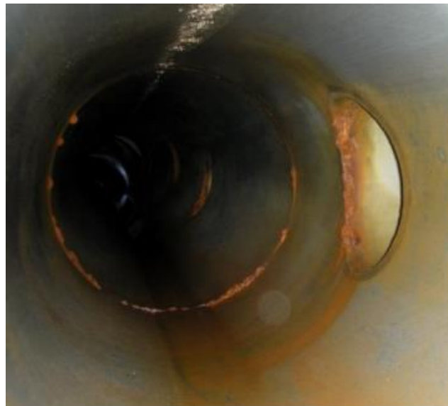
Slika 16. Nakupine bakterija na zavarenom spoju stijenke cijevi od čelika EN 1.4307 [20]
