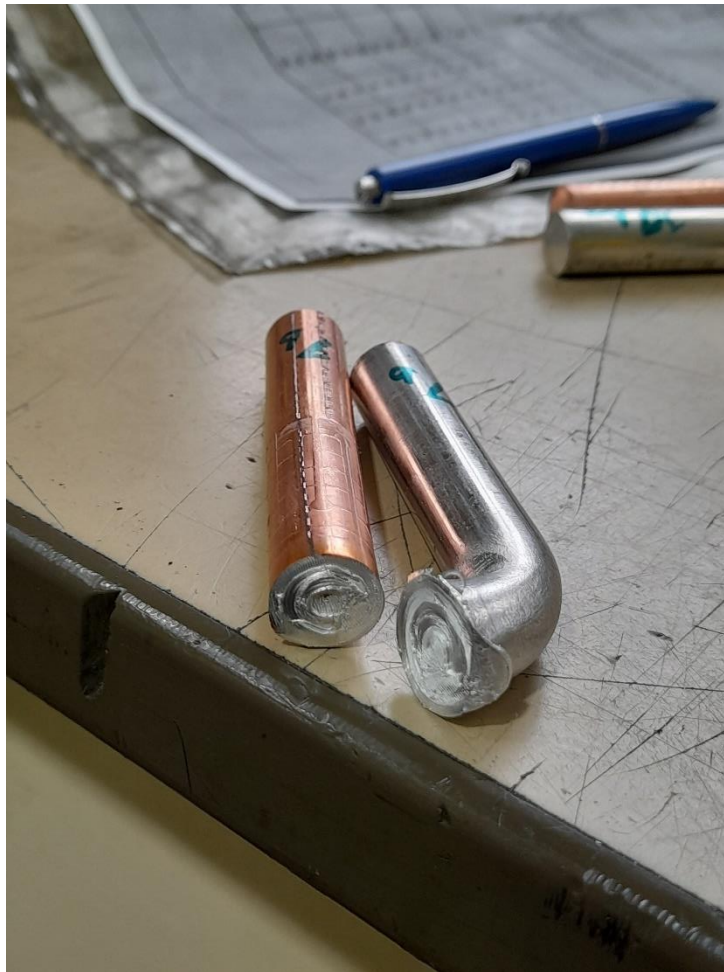
Slika 56. Neispravno puknuće spoja
