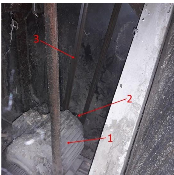
Slika 8. Elektromotor s remenskim prijenosom (1 - elektromotor, 2 - remenica, 3 - remen)
