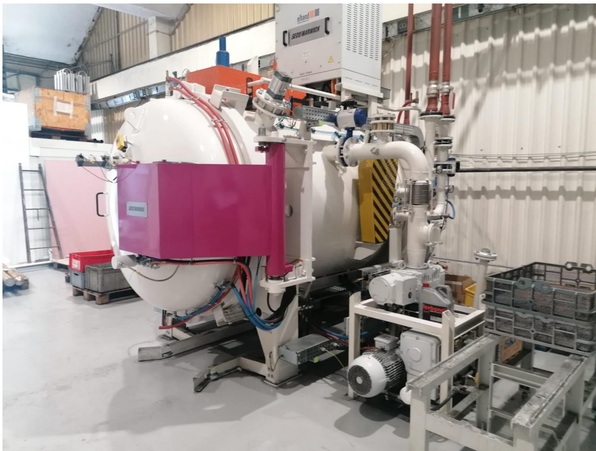
Slika 31. Vakuumska peć sa vakuumskim sustavom u Centru toplinske obrade d.o.o.
