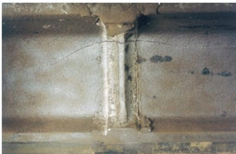
Slika 9. Primjer pukotine označene kodom 422 [13]
