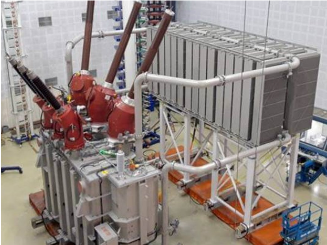
Slika 2.13 Odvojeni sustav za hlađenje transformatora 9 [12]
