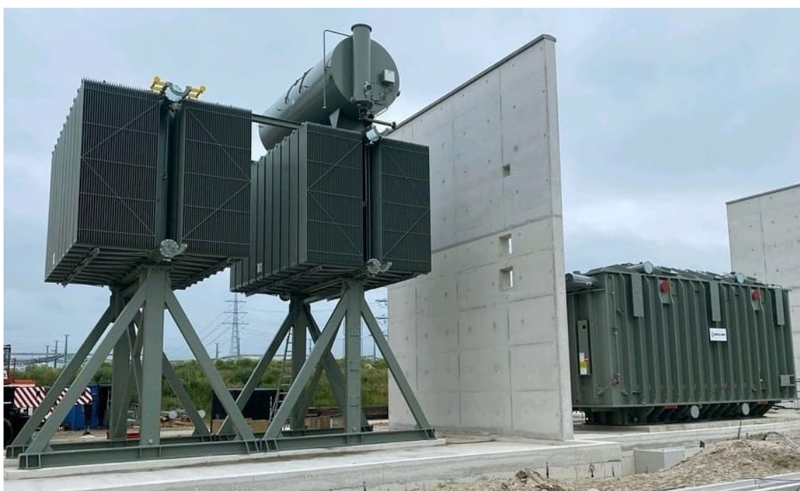
Slika 2.12 Odvojeni sustav za hlađenje transformatora 8 [11]
