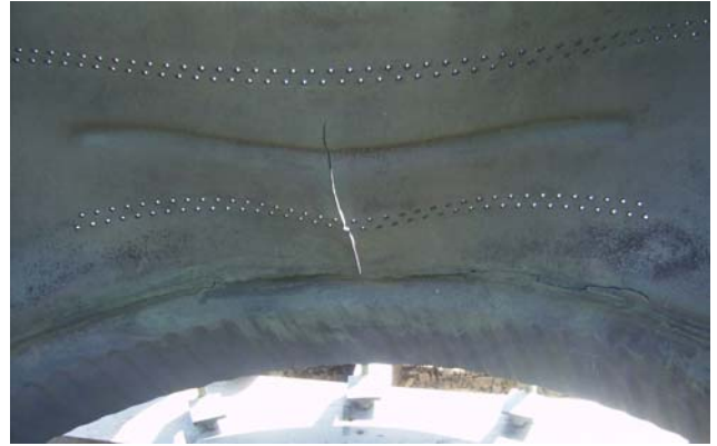
Slika 4.4 Unutarnja strana kućišta vrućih plinova, s kojeg je izrezan uzorak za ispitivanje
