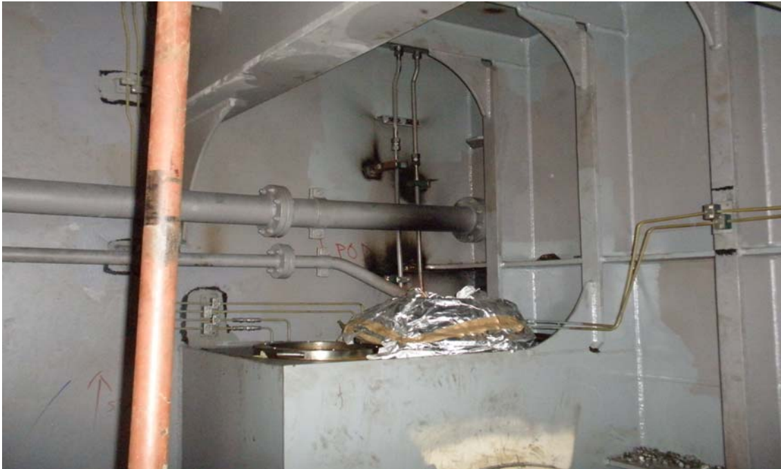
Slika 66. Uništeni premaz na kopaču, detalj iz Brodogradilišta Uljanik, Pula
