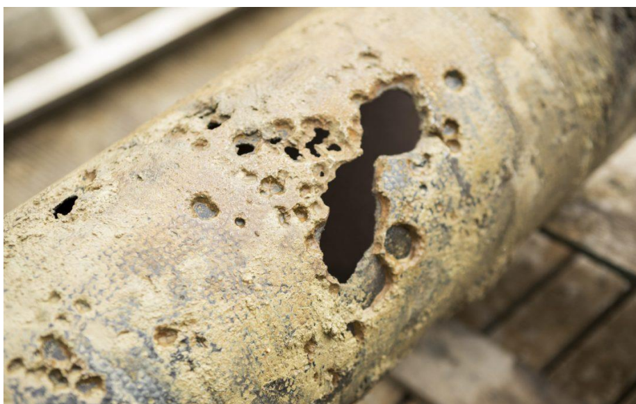
Slika 13. Primjer rupičaste korozije [18]
