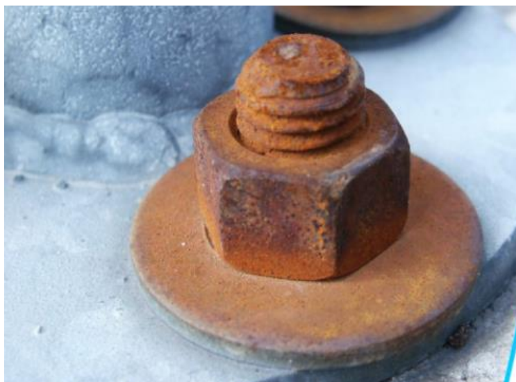
Slika 17. Primjer galvanske korozije [22]
