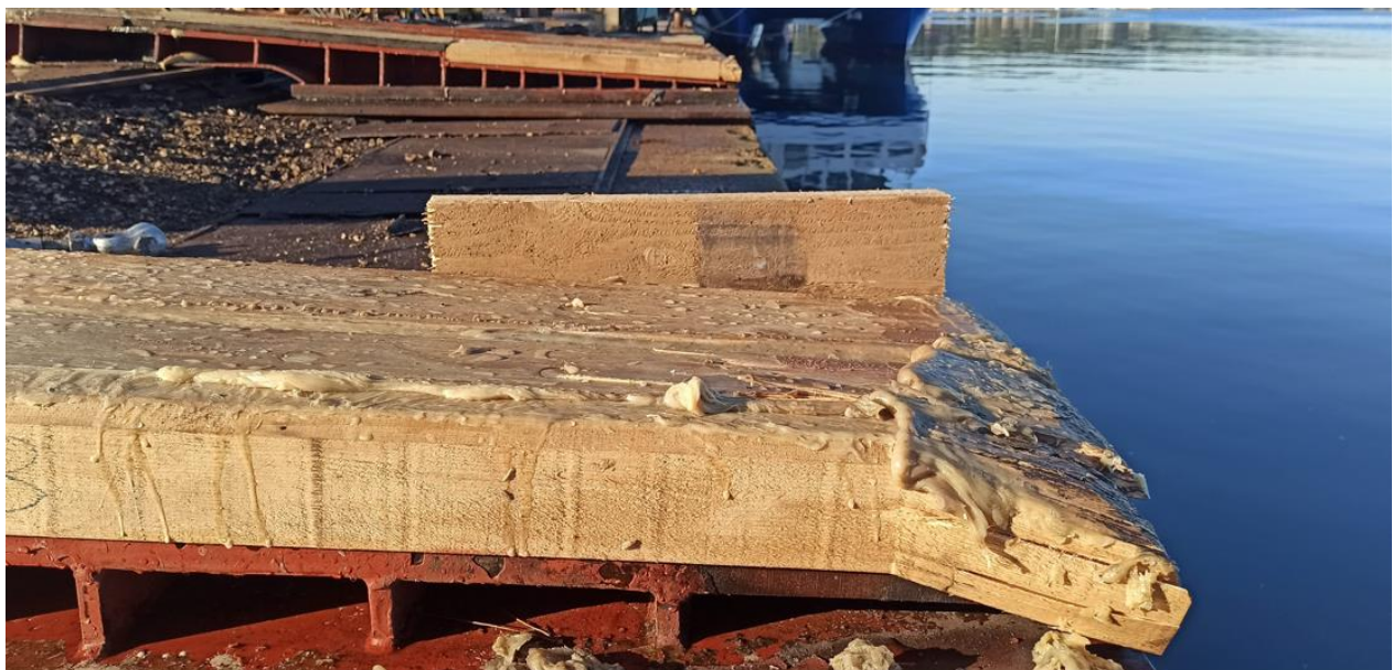
Slika 35. Prikaz oštećenja drvene podloge.
