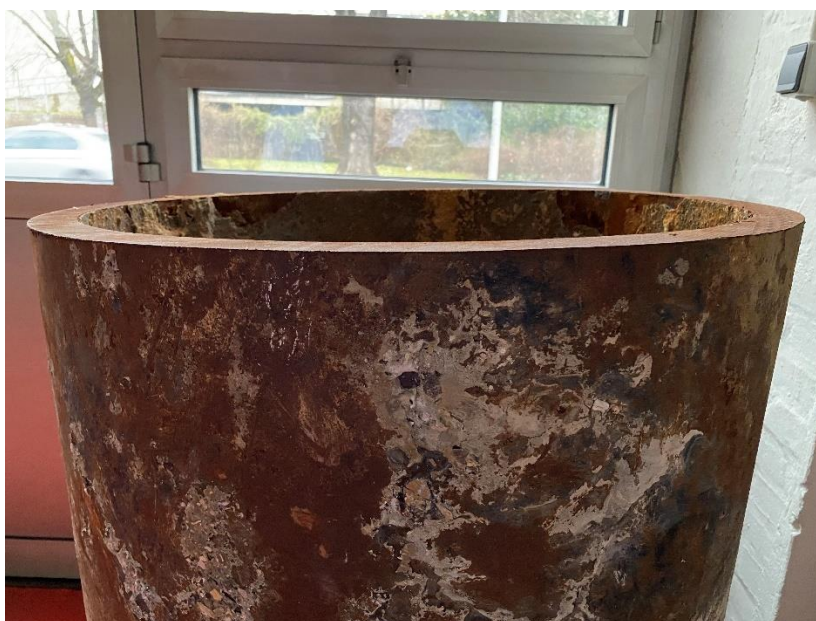
Slika 11. Dio cijevi iz eksploatacije
