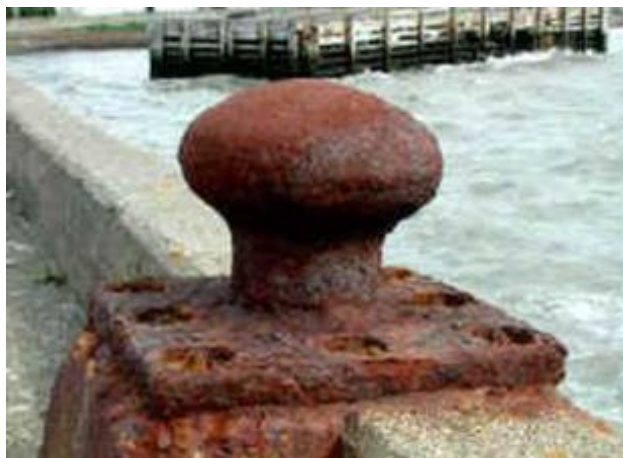
Slika 14. Opća korozija stupa za vez broda [22]
