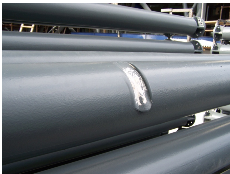
Slika 4. Oštećenje premaza pri transportu
