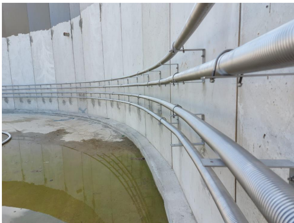
Slika 35. Cijevi izmjenjivača topline u digestoru [29]
