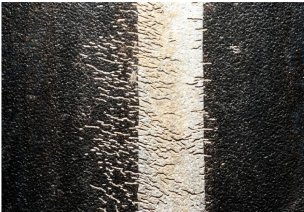
Slika 13. Pojava pukotina zbog napetosne korozije na zavaru cijevi od nehrđajućeg čelika [27]
