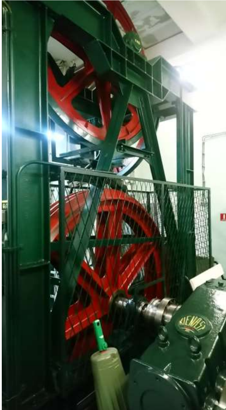
Slika 22 Kolature - slika sa servisa 25.10.2021.
