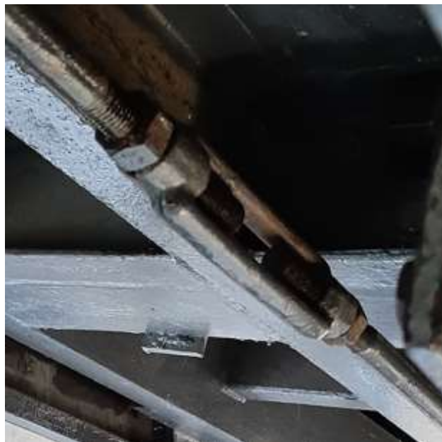
Slika 32 Spoj navojnog mosta i šipki - slika sa servisa 25.10.2021.
