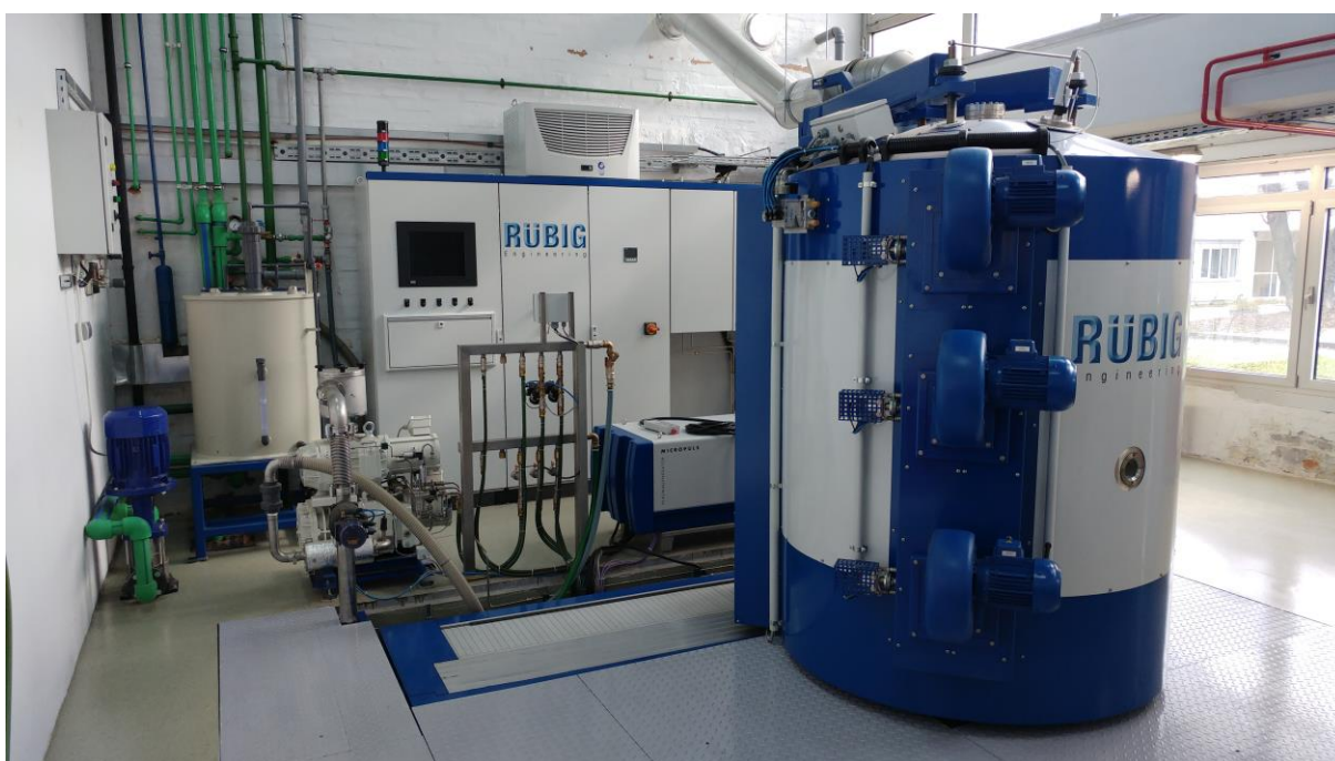
Slika 14. PACVD postrojenje instalirano na FSB-u [12]
