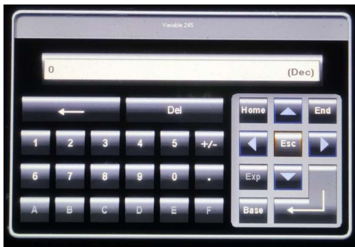
Slika 50. Iskakajuća tipkovnica na zaslonu PLC uređaja
