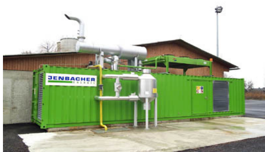
Slika 5.3. Vanjska ugradnja kogeneracijske jedinice
