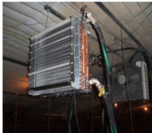
Slika 4.5. Izmjenjivači topline sa ventilatorima
