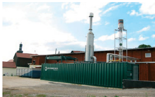
Slika 5.4. Vanjska ugradnja kogeneracijske jedinice
