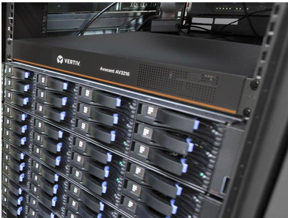
Slika 6. Server Avocent AV3216 smješten u IT ormar [3]
