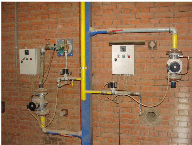
Slika 60. Demontaža bočnih HG plamenika
