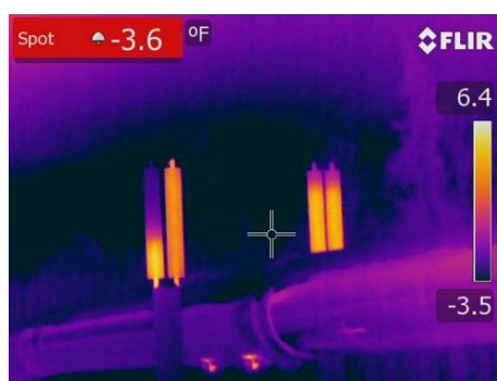
Slika 10.11 Termo sifoni snimljeni termo kamerom [81]
